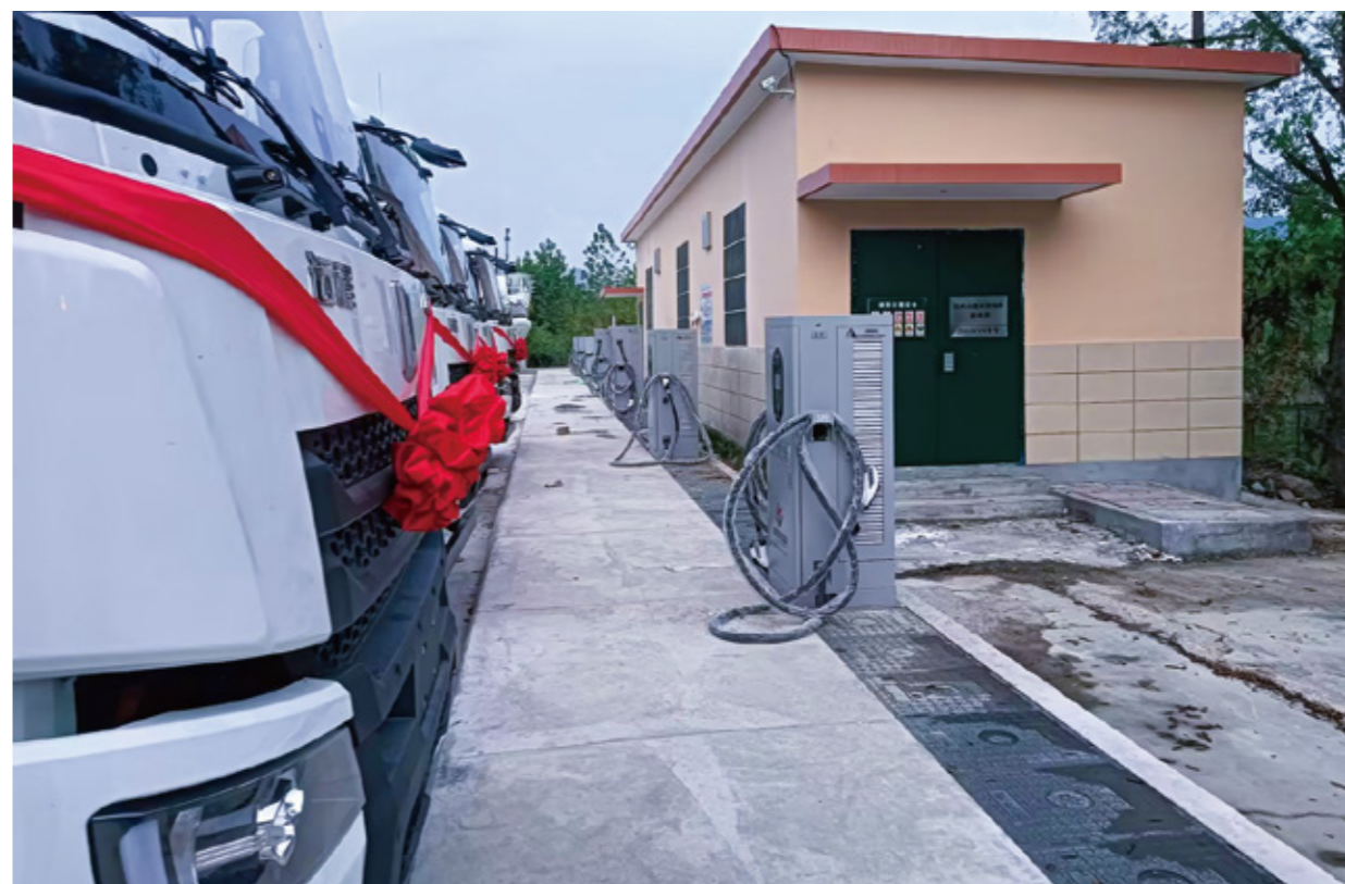
杭州重卡超充站
